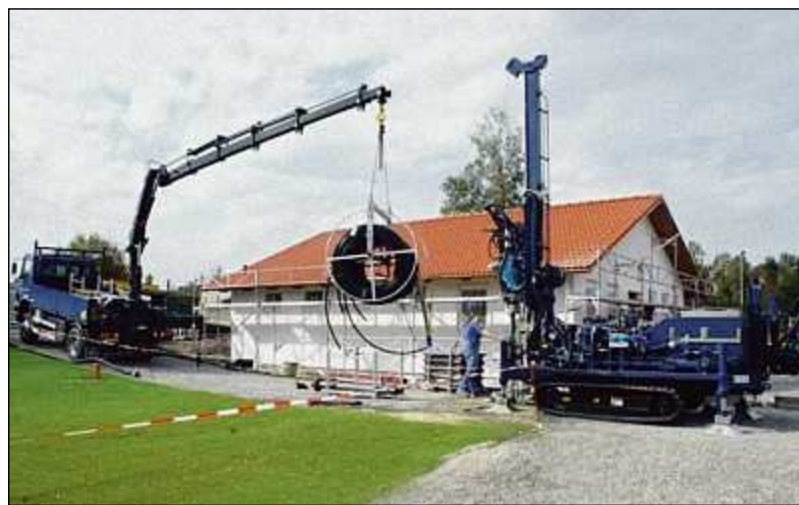
Erdwärme ist ein technologisches Spitzenprodukt. Erfahrene Bohrfirmen wie Baugrund Süd stehen für einen guten Service und eine sichere Ausführung. FOTO: BSZ
