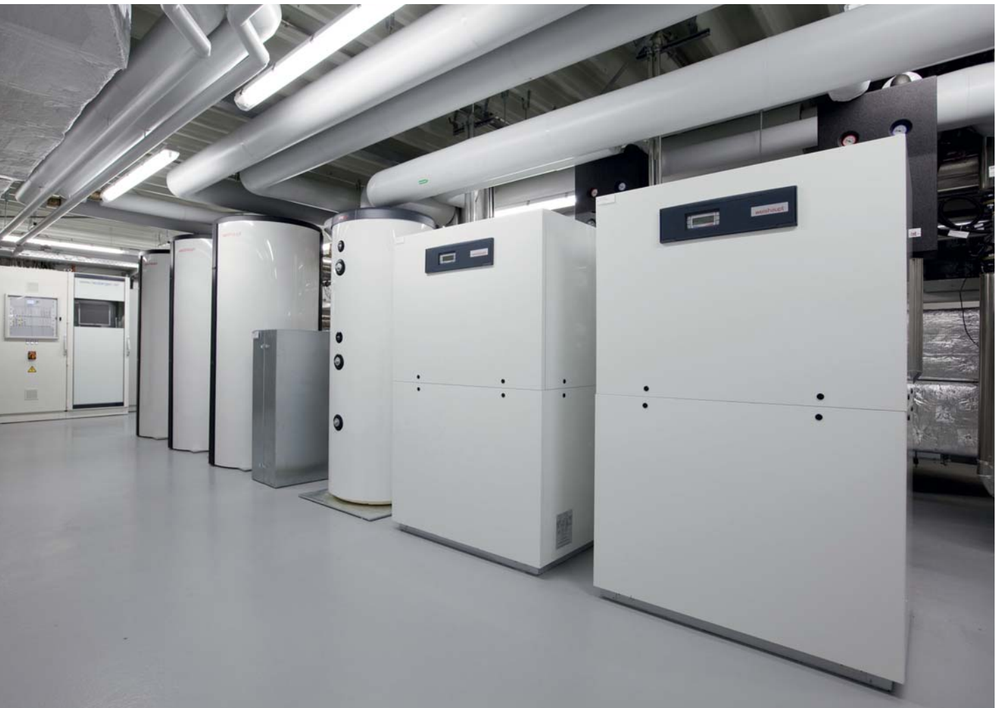
Abb. 4 – Ein Blick in die Heizzentrale zeigt die Wärmepumpenkaskade sowie diverse Pufferspeicher, in denen auch die Abwärme aus Schulungskesseln gespeichert wird.
