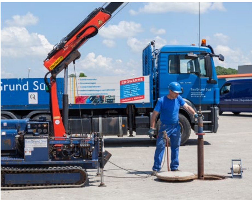
Kolbgerät: Der Kolben wird im Brunnenrohr auf- und abgefahren. Dabei werden Ablagerungen aus dem Ringraum in den Brunneninnenraum gesogen und können mittels Pumpen entfernt werden
